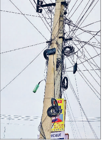
रेवाड़ी। बावल रोड पर बिजली के पोल पर लटकते केबल के तार, सेक्टर-1 में खंबे पर लटकते केबल के तार, मॉडल टाउन में बिजली पोल पर केबल का जंगल।
